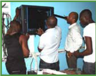
le câblage réseau et l'aménagement des labs info;
